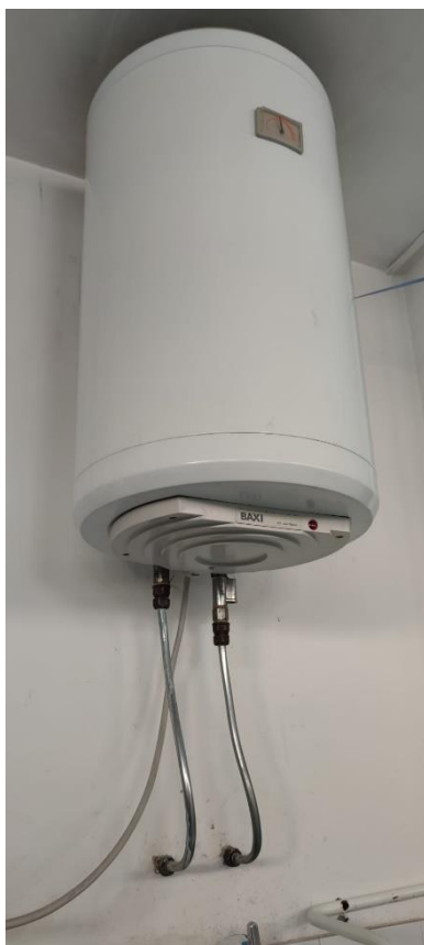
Figura 2 Boiler elettrico per l'ACS
