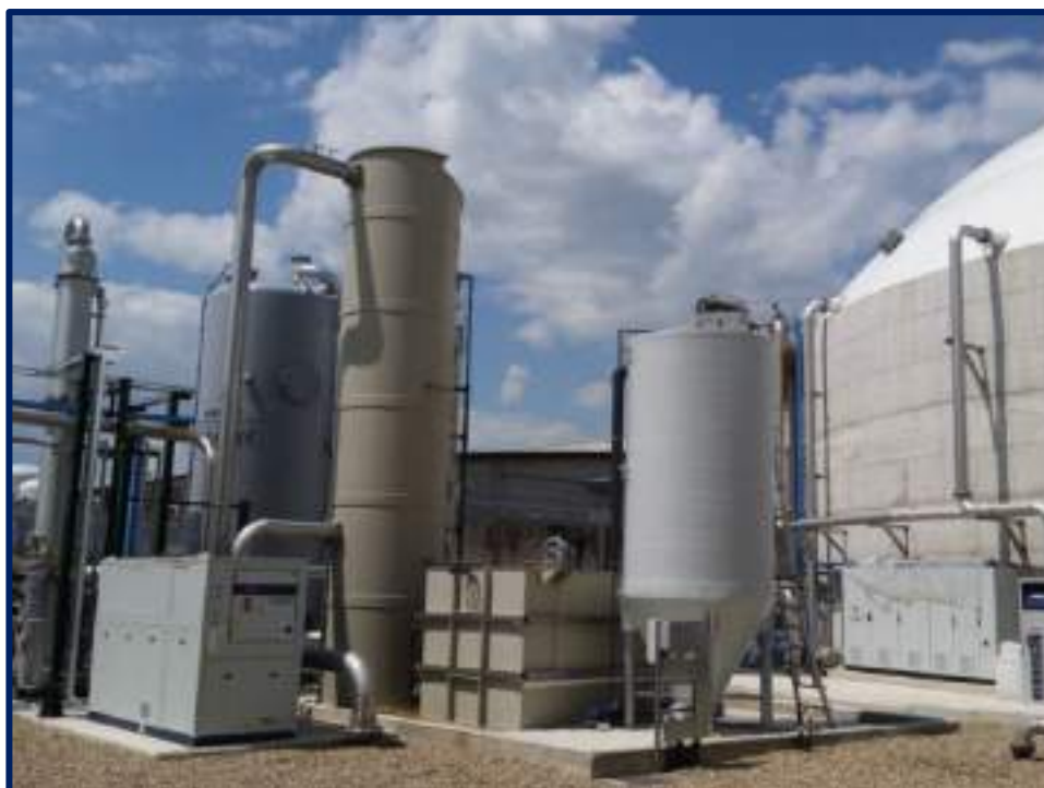
Figura 2 Torre Scrubber per abbattimento dell'Acido Solfidrico
