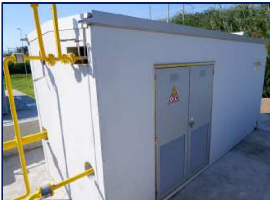
Figura 15 Cabina REMI alloggiata in cabinato in Cemento Armato Vibrato
