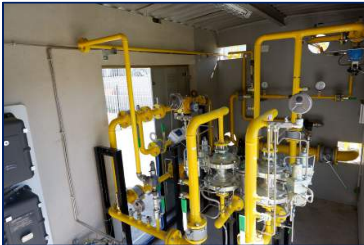
Figura 18 Particolare del piping e del sistema di supporto
