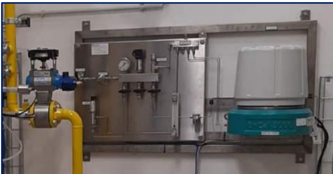
Figura 17 Particolare del pannello di misura della qualità del biometano prodotto
