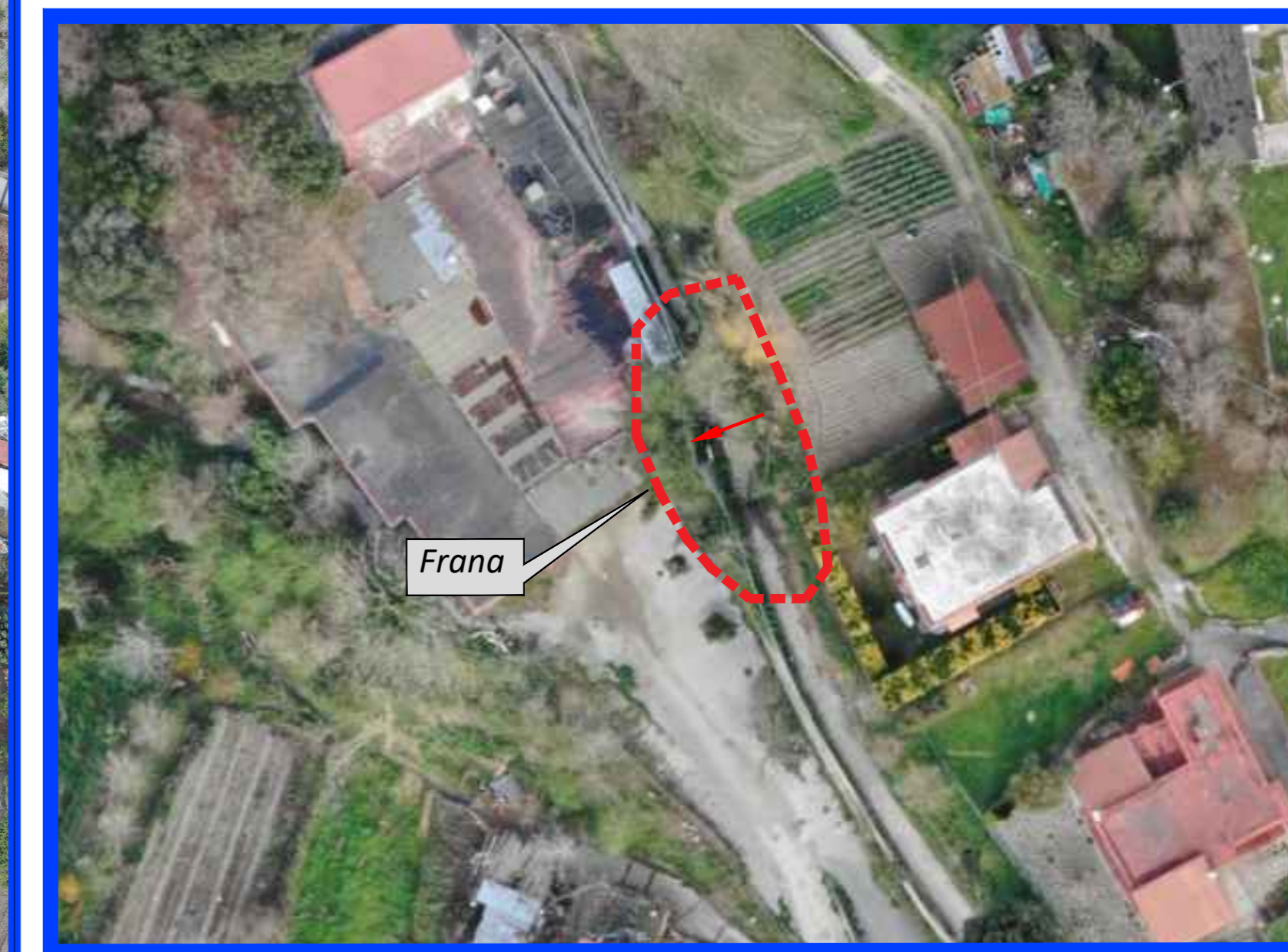
Sprofondamento strada via Cupa Camaldoli
