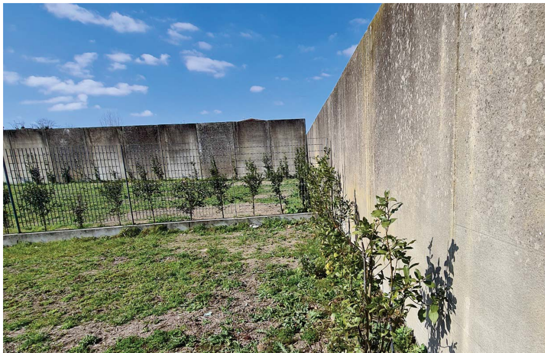
IMMAGINE 3: PARTICOLARE RECINZIONE IN ORSOGRILL E MURO IN CLE PERIMETRALE LATO NORD
