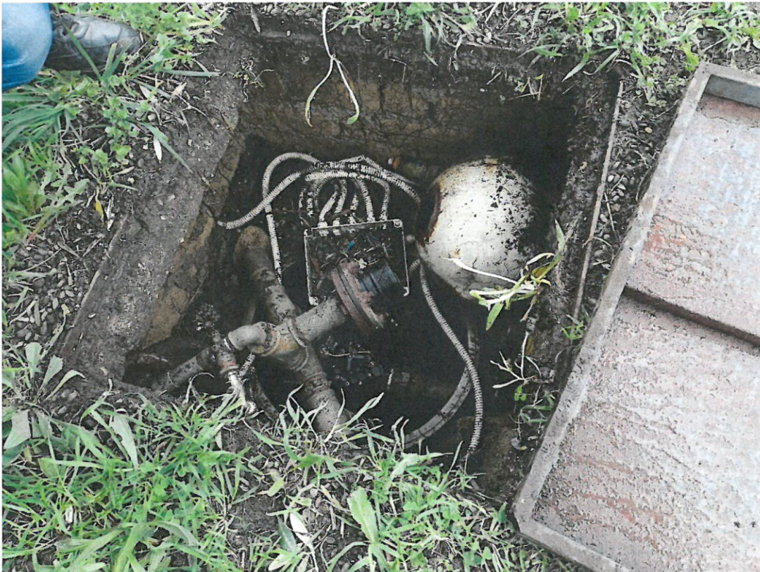
Foto N. 1 Particolare della vasca raccolta acque meteoriche con galleggiante.
