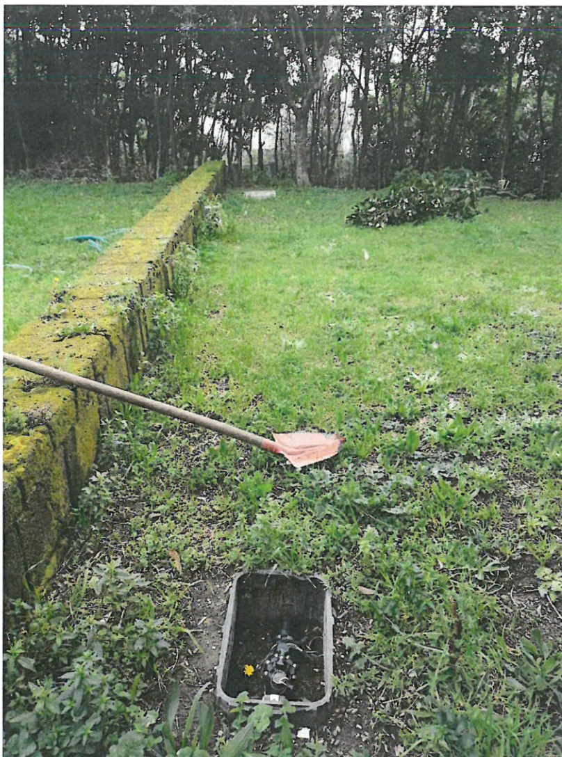
Foto n. 2: pozzetto con centralina impianto irriguo
