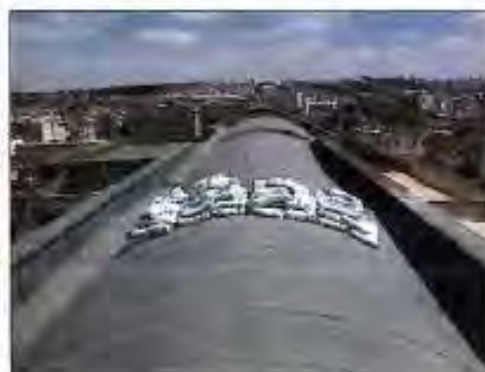
Particolare della zavorra utilizzata per applicare il carico sul solaio di copertura (livello 8).
