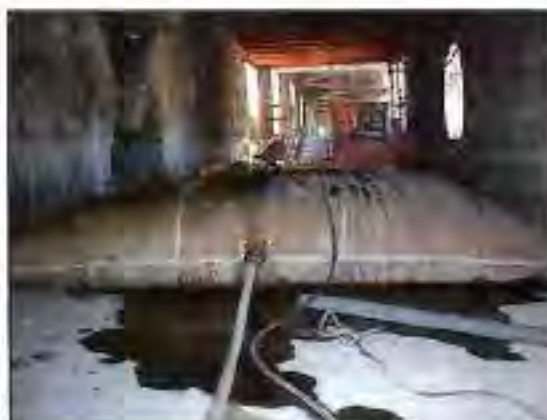
Particolare del serbatoio di carico posizionato sul solaio.
