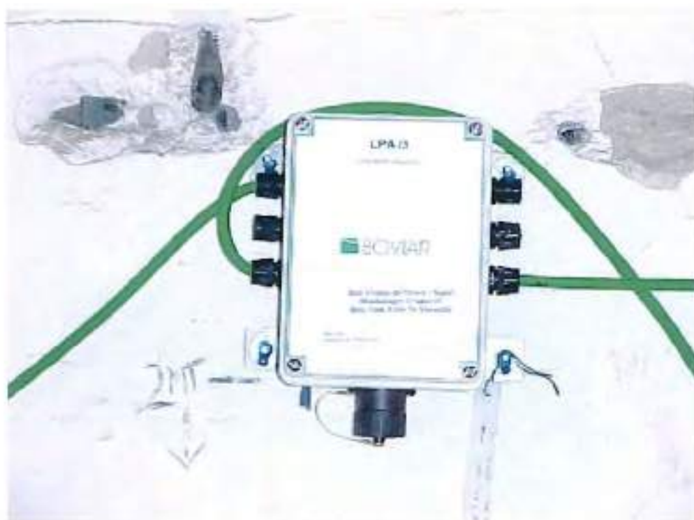
Centralina di acquisizione
