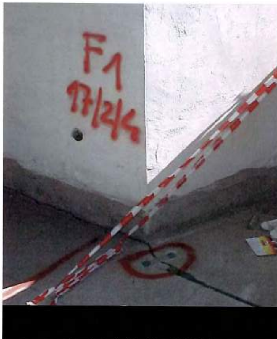
Fessurimetro installato il giorno 17/02/2004
