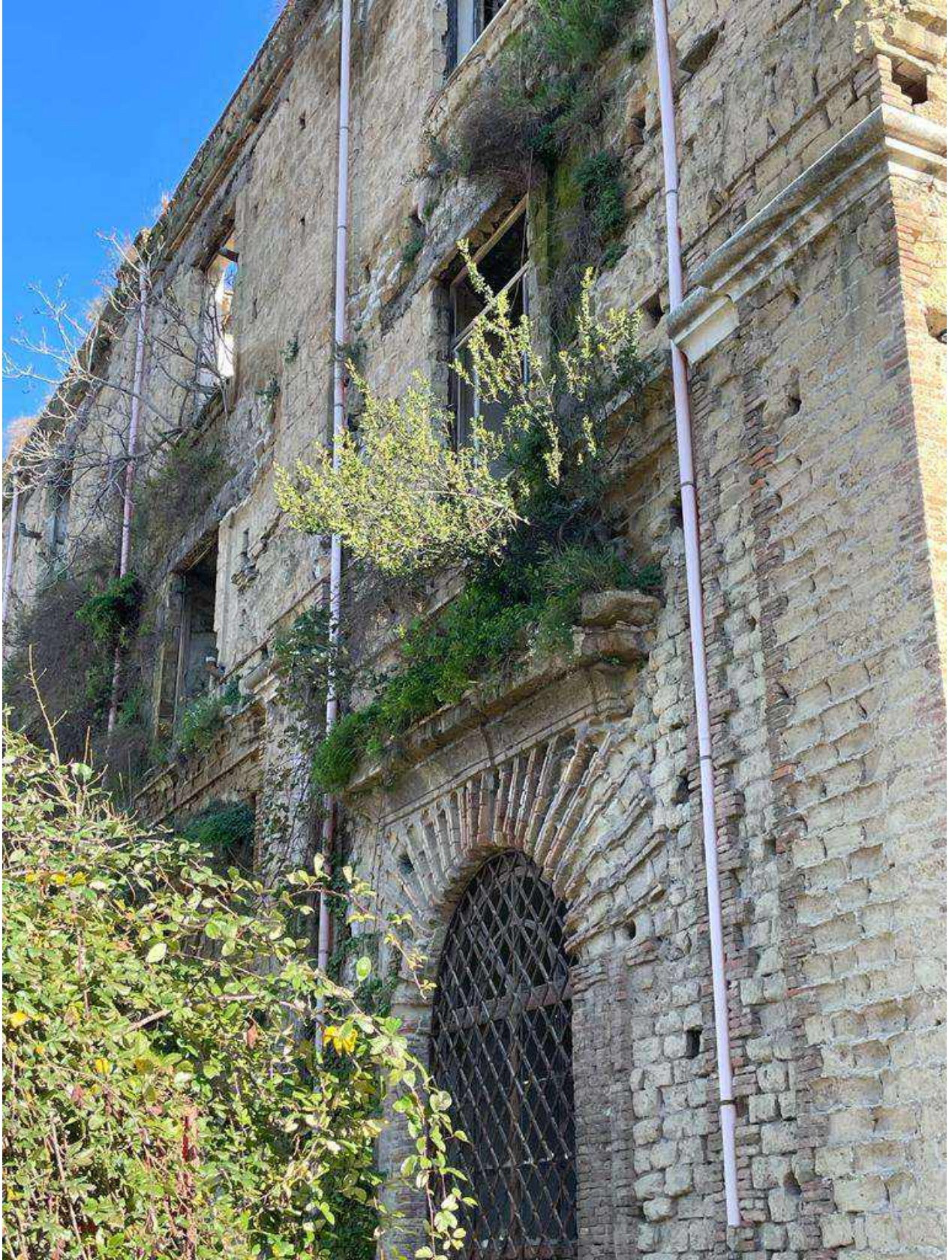
Il prospetto a nord dell'edificio presenta i danni dell'umidità più rilevanti dell'intero edificio.
