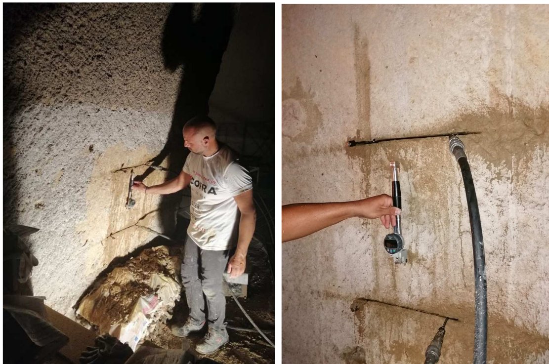
Figura 18. Prove con martinetto piatto doppio eseguite per la valutazione della tensione di rottura.
