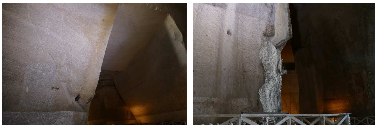
Figura 15. Putrelle metalliche ossidate infisse nell'ammasso tufaceo
