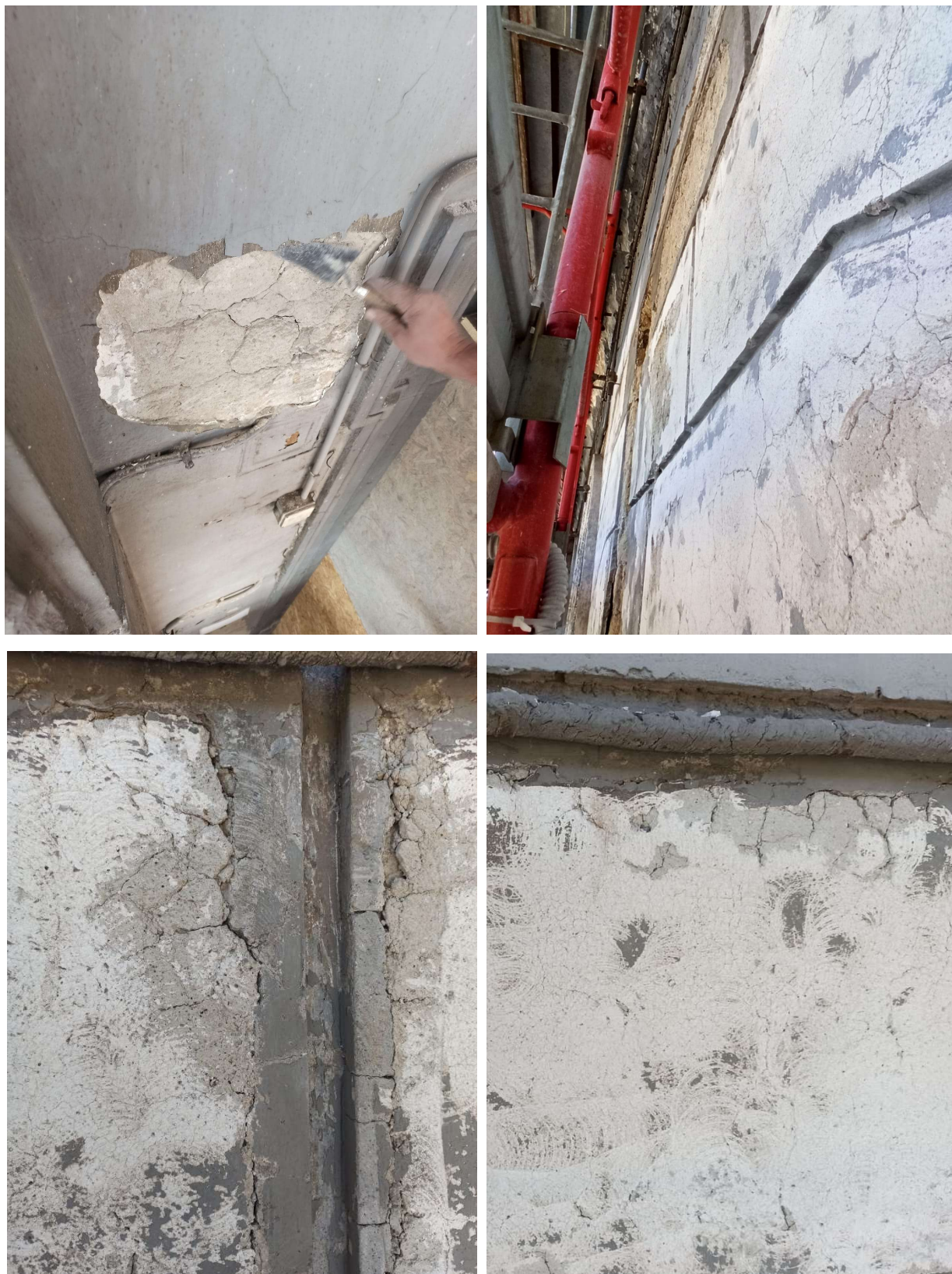
Figura 2 - Decoesione degli intonaci
