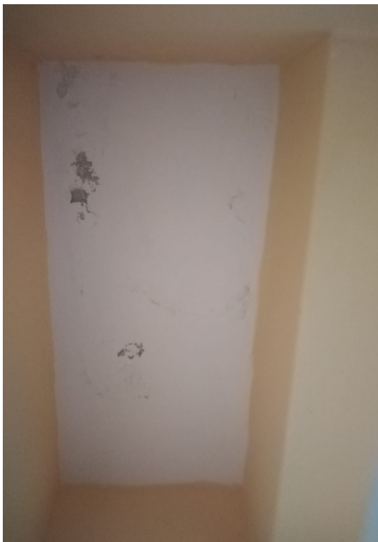
Figura 16: solai ingresso sala psico-motorio
