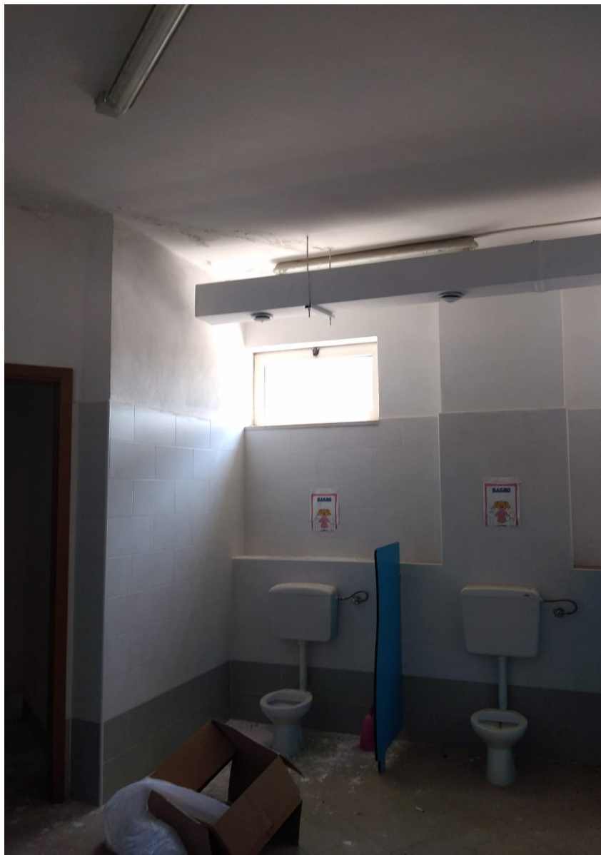
Figura 18: solaio bagno - zona wc
