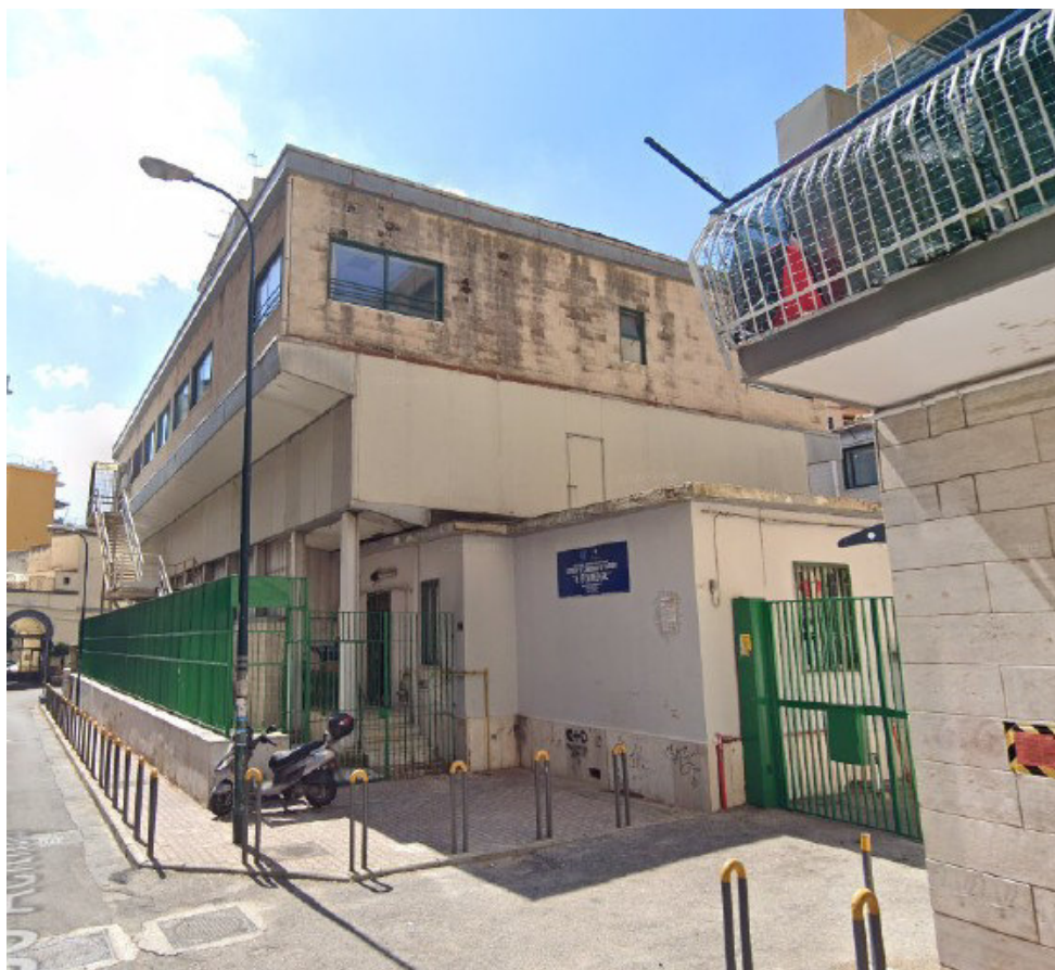
infiltrazione da gronda prospetto principale
