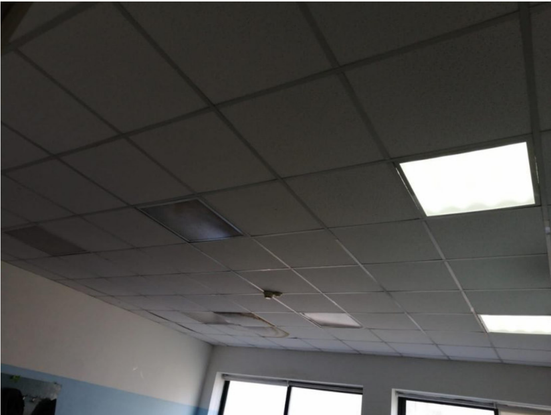
Controsoffitti danneggiate con lampade fuori uso
