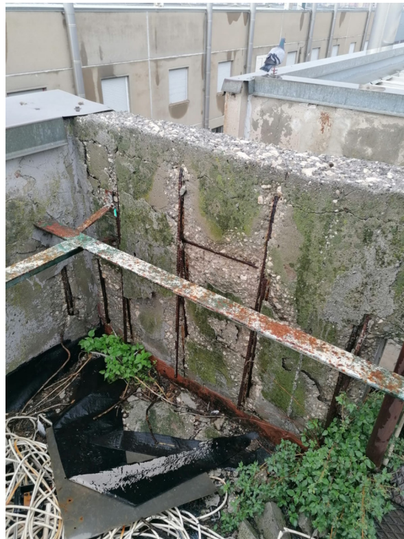
7. Muro perimetrale torrioni scala presenza di fenomeni di degrado del cls e corrosione armature
