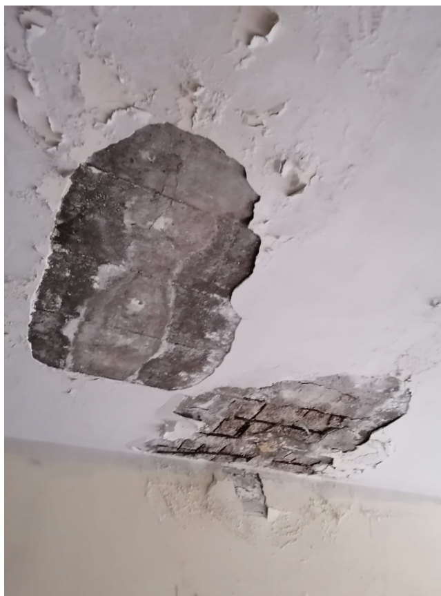
10. Fenomeni infiltrativi al di sotto della copertura
