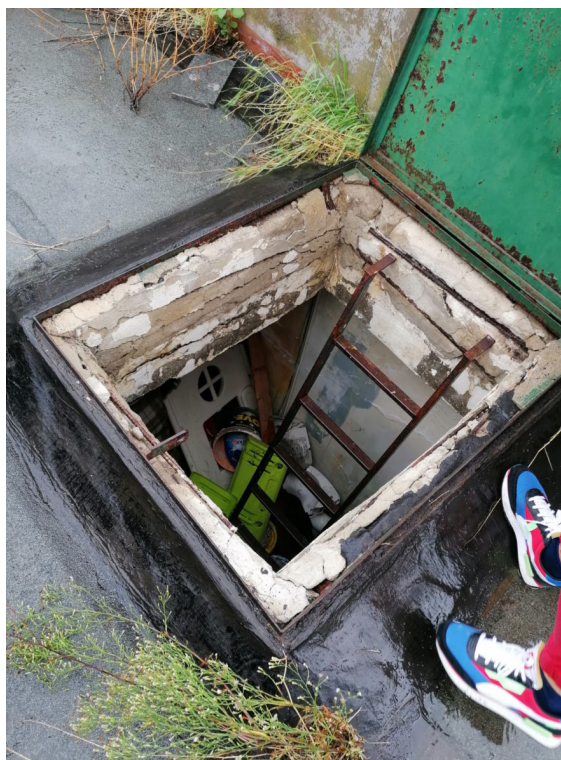
8. Botole di accesso torrini scala presenza di fenomeni di degrado del cls e corrosione armature
