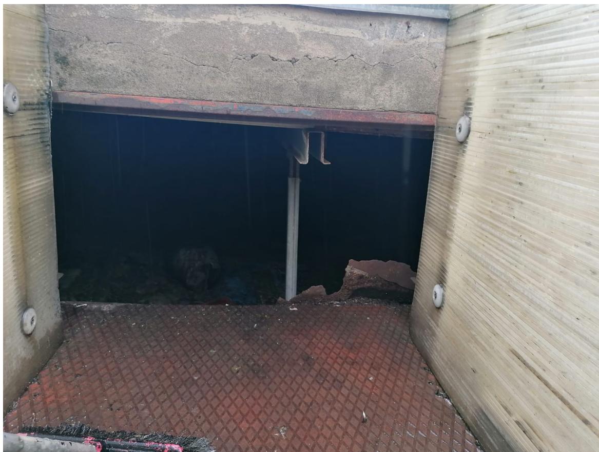
9. Sottostruttura in acciaio lamiera – presenza di guano, caogne e impianti
