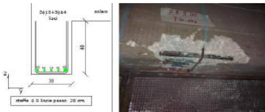
Figura 13 Saggio trave P 8-9 – piano interrato
