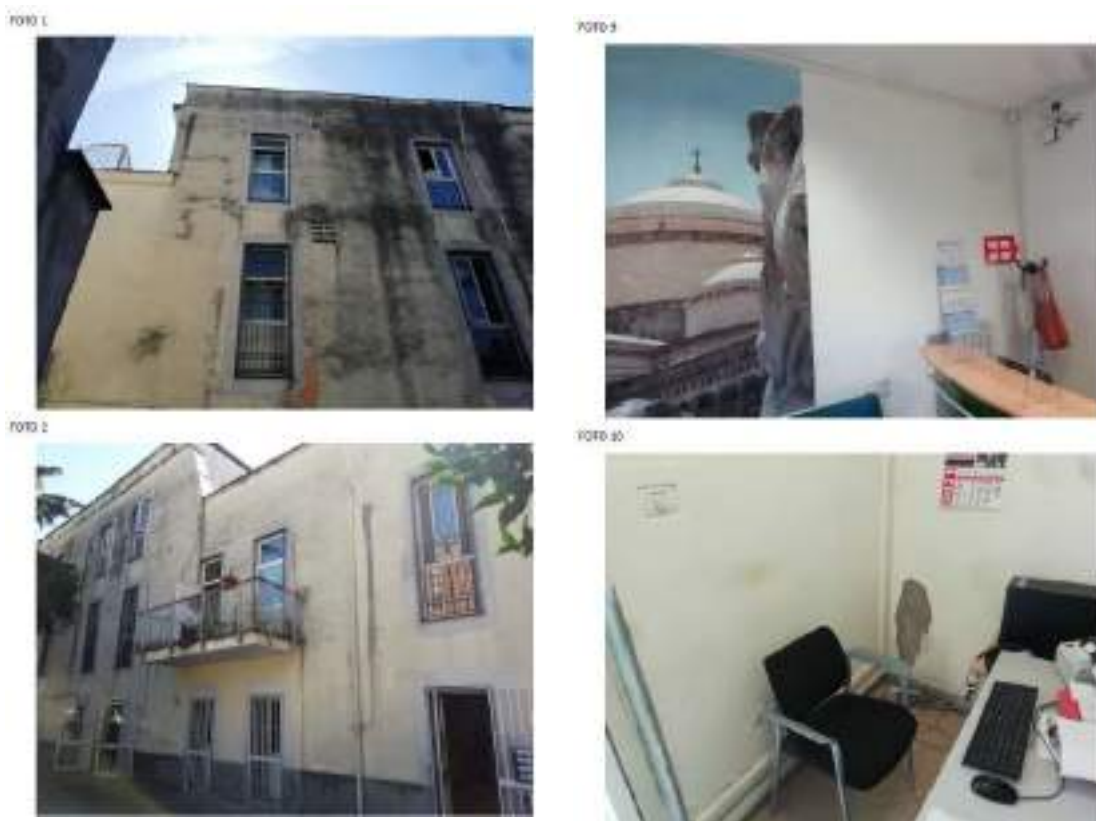
Figura 3-4: Stato del degrado esterni ed interni
