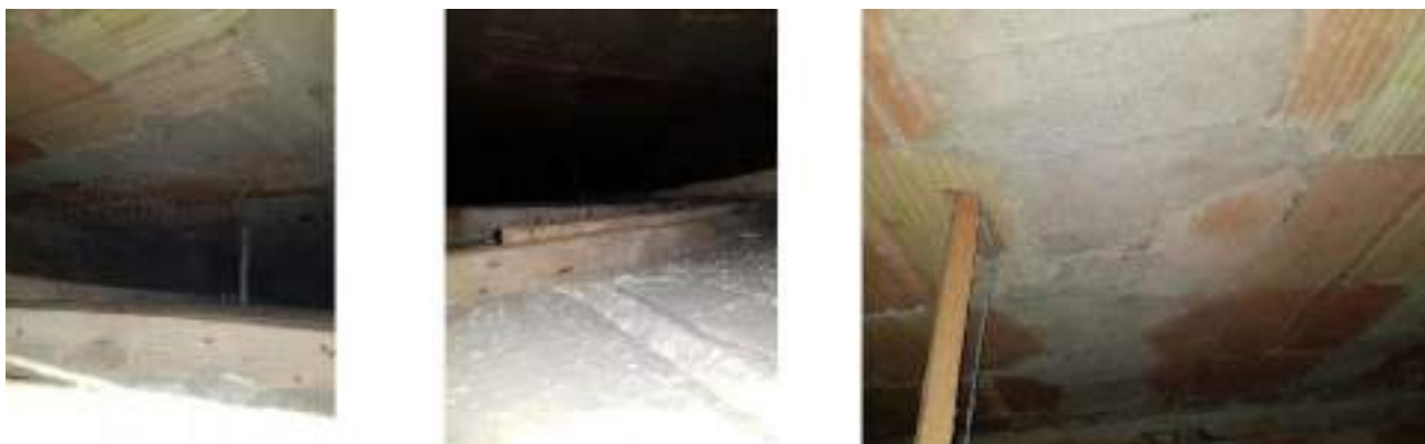
Estratto dalla Relazione Tecnica sulle indagini sui solai: Documentazione fotografica del controsoffitto
