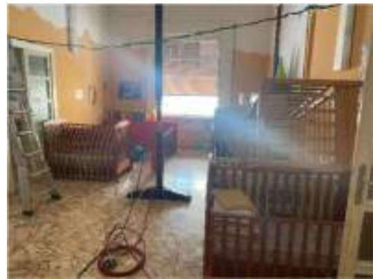
Estratto dalla Relazione Tecnica sulle indagini sui solai: Strumentazione di carico – Piano primo
