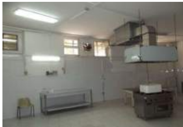
Macchinari “appesi” al solaio
