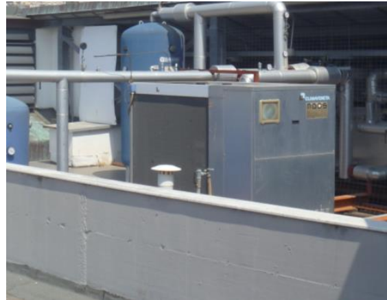
Figura 5-4. Particolare della pompa di calore per unità consiliare.
