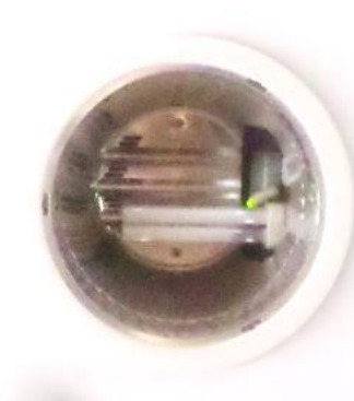
Figura 5-6. Particolare corpi illuminanti.
