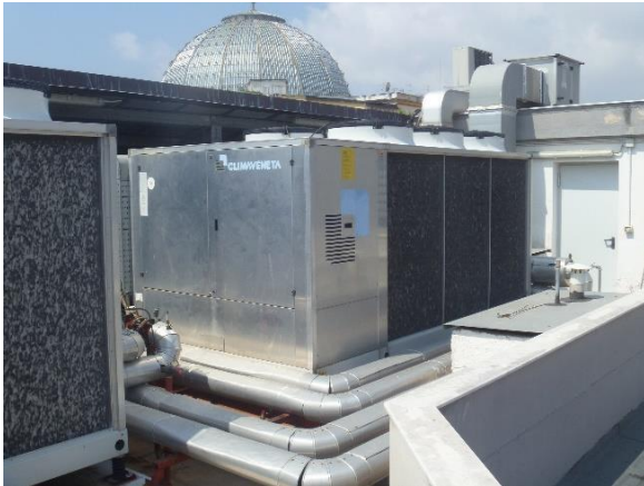
Figura 5-3. Particolare della pompa di calore principale.
