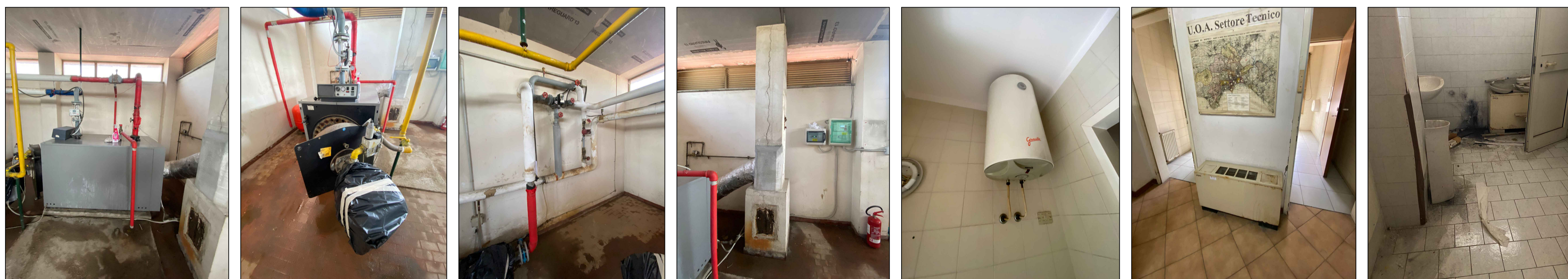
Rilievo fotografico impianto termico: rete di distribuzione e terminali
