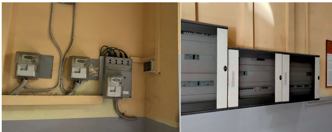
Figura 2 Quadri e contatori elettrici al piano terra
