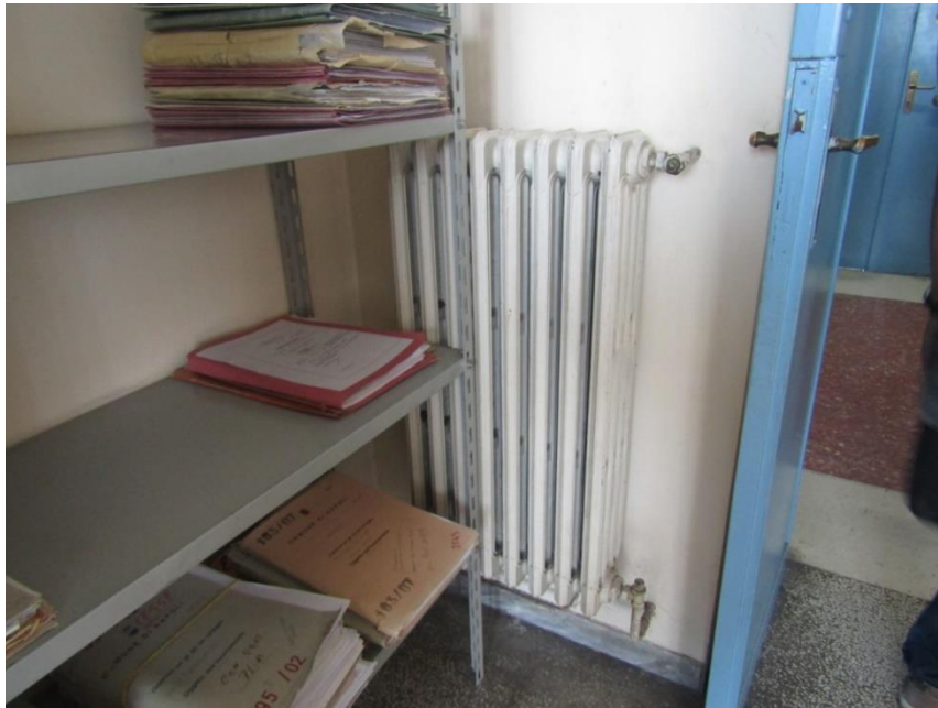
Figura 8 - Particolare corpi radianti
