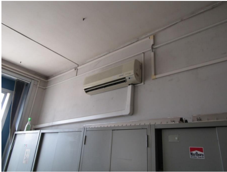
Figura 10 - Particolare condizionatori split
