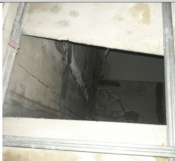
Immagine relativa al degrado dovuto ad infiltrazioni
