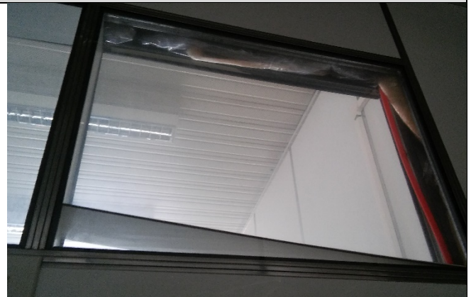
Immagine relativa al degrado delle partizioni interne.
