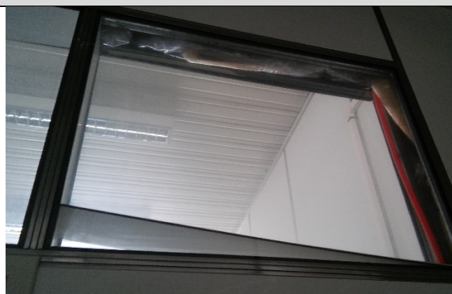
Immagine relativa al degrado delle partizioni interne.
