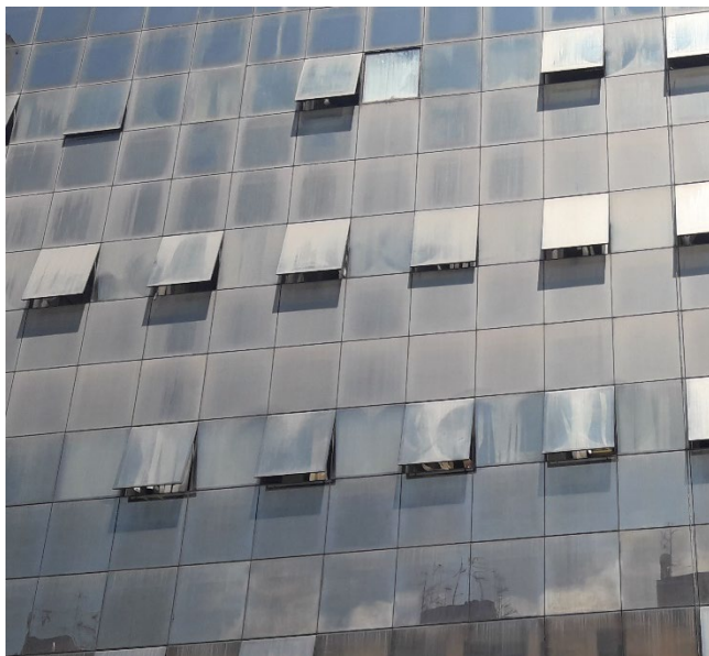
Immagine relativa al degrado della parte più esterna del vetro di facciata
