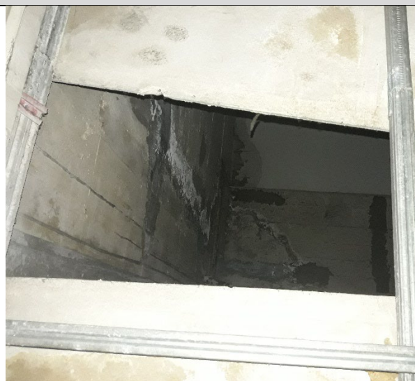
Immagine relativa al degrado dovuto ad infiltrazioni
