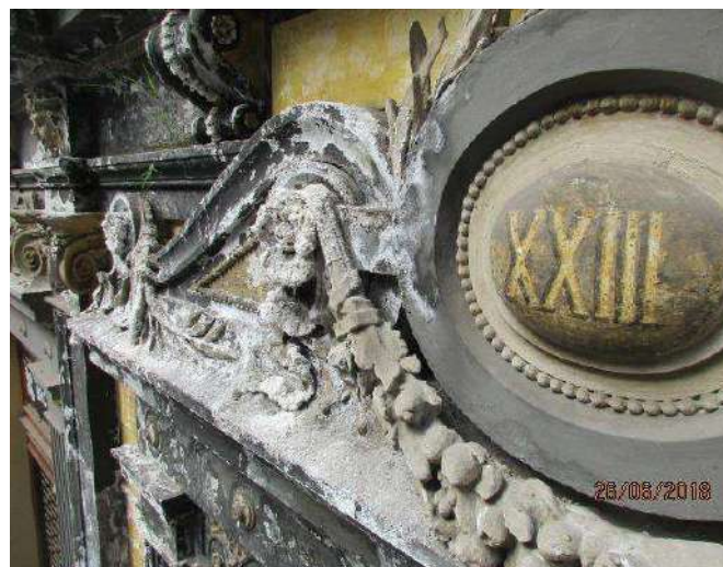
Figura 28– Decorazione a stucco interessata da probabile processo di solfatazione
