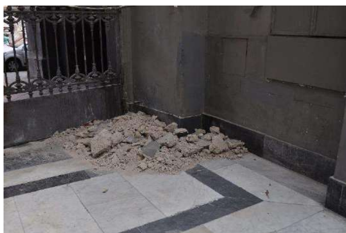
Figura 2 – Frammenti di intonaco distaccatisi
