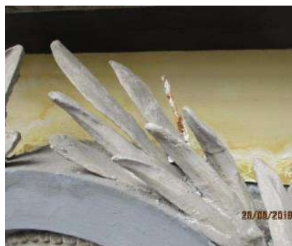
Figura 30 –Decorazione a stucco con elementi metallici ossidati
