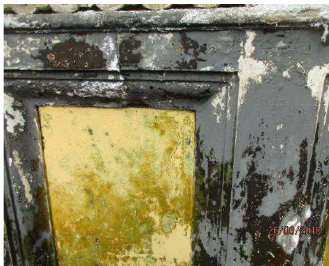
Figura 27 –Zona interessata da degrado generato dal percolamento di acqua dal soffitto
