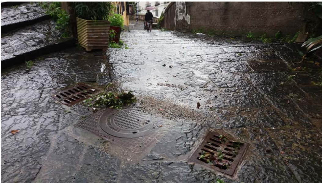
Figura 3 - salita Pietraio: ristagno in corrispondenza di caditoie esistenti
