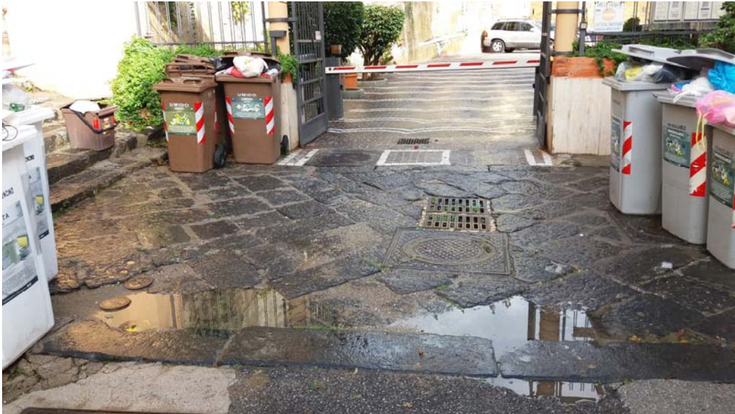
Figura 4 - salita Pietraio: ristagno in corrispondenza di caditoie esistenti
