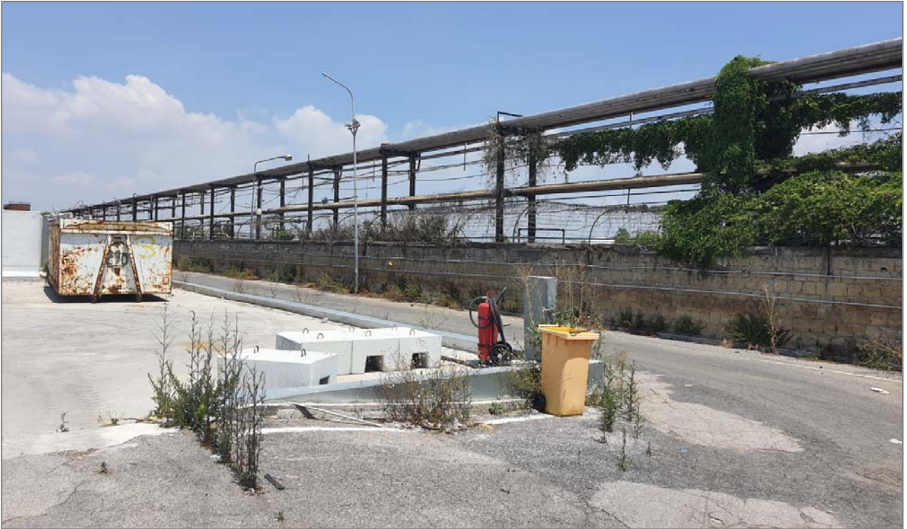
Fig.28 FOTO 09 – Struttura metallica di sostegno di tubazioni aeree posta a fianco del confine Est dell'area
