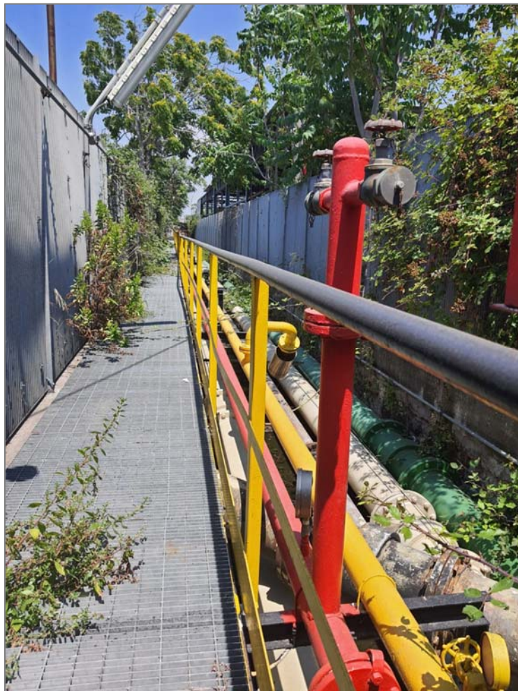
Fig.21 FOTO 02 – Vista interna dell'area delimitata dell'oleodotto e del relativo impianto antincendio
