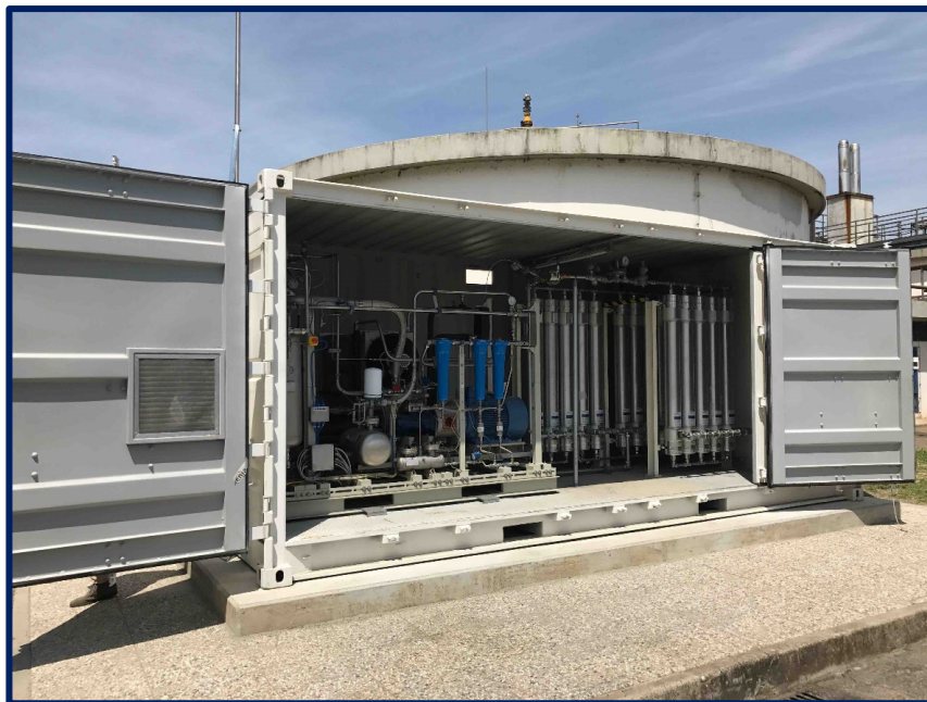
Figura 9 Installazione Tipica in Container da 40'
