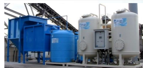
Impianti di Depurazione Acque Reflue e di Falda
