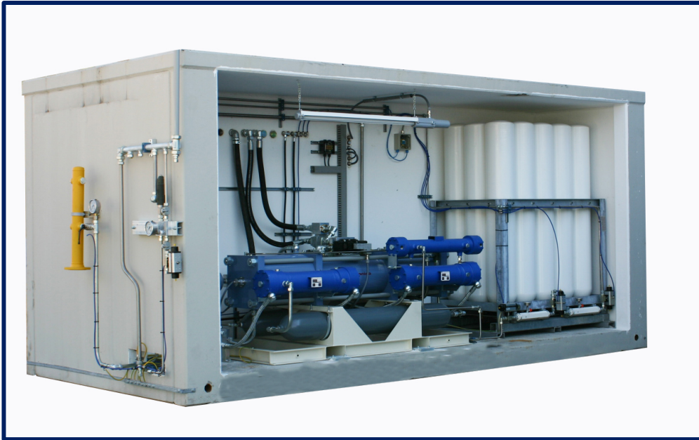
Figura 12 Rappresentativo di un compressore alloggiato in cabinato in cemento armato
