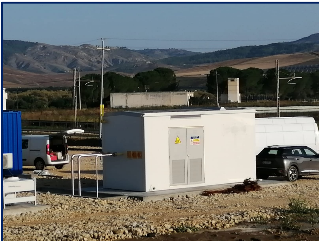
Figura 13 Cabina REMI alloggiata in cabinato in Cemento Armato Vibrato
