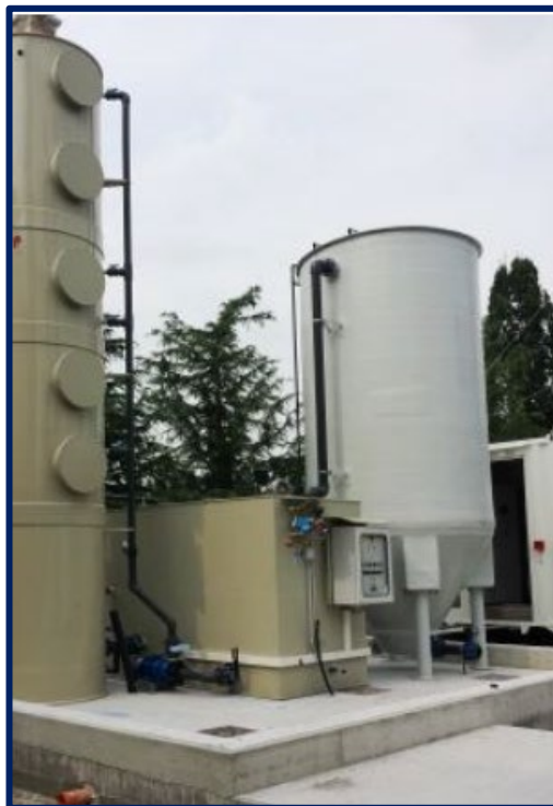
Figura 2 Torre Scrubber per abbattimento dell'Acido Solfidrico
