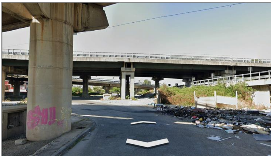
Figura 14 – Immagine di Via De Roberto, al di sotto del Viadotto della SS 162 Dir
