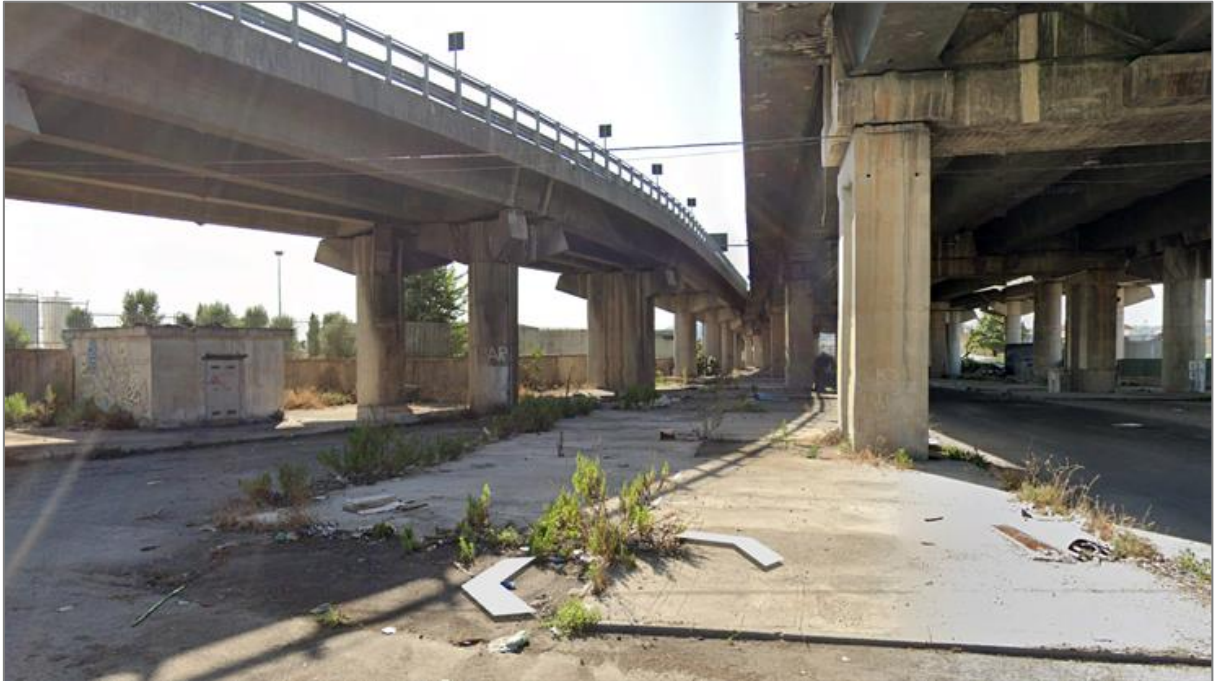
Figura 6 – Immagine di Via De Roberto, al di sotto del Viadotto della SS 162 Dir (sulla sinistra si trovano l'area di progetto, oltre la recinzione, e la cabina elettrica esistente ben visibile)
