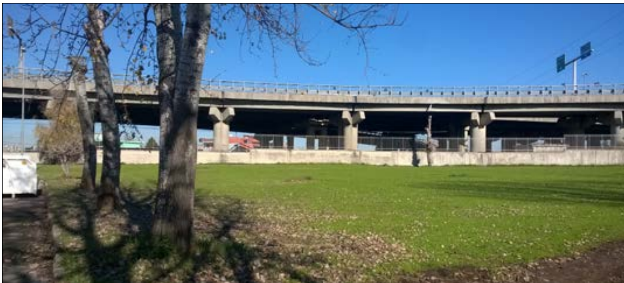
IMMAGINE 7 - Vista della sopraelevata e della sottostante Strada Comunale Galeone poste sul confine Nord
