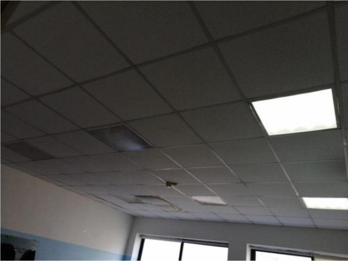
Controsoffitti danneggiate con lampade fuori uso
