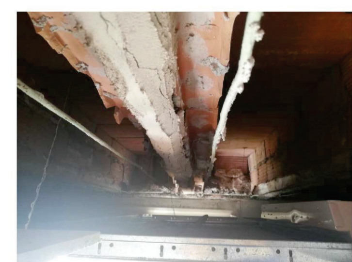
Foto 1: Stato di fatto Travetti
