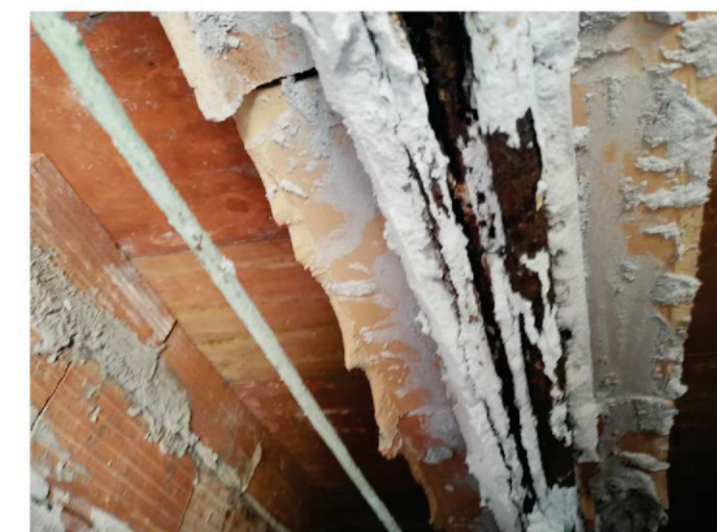
Foto 2: Stato di fatto Travetti
