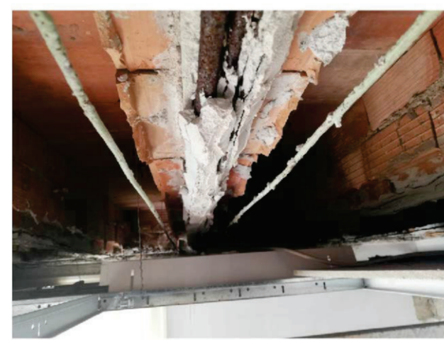
Foto 3: Stato di fatto Travetti
