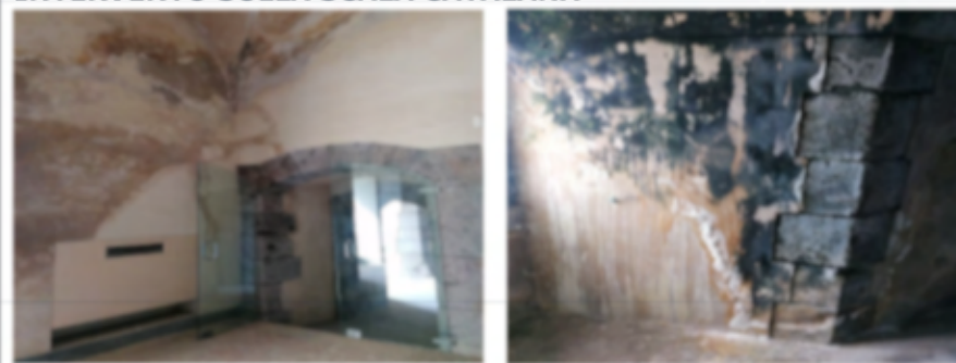
INTERVENTO N°10 INTERVENTO NEL MATRONEO DELLA SALA DEI BARONI E INTERVENTO SULLA SCALA CATALANA
